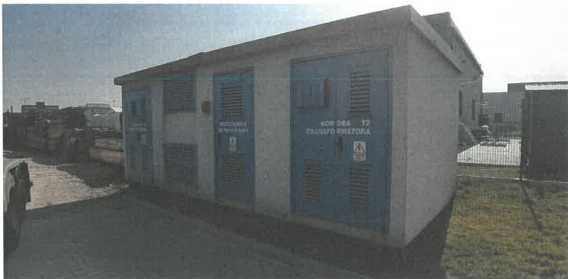
Zdjęcie 14. Rozdzielnia SN 15 kV.
