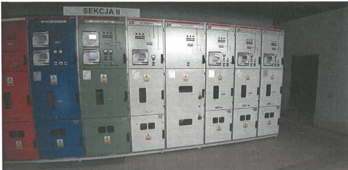
Zdjęcie 13. Rozdzielnia SN 6 kV – Zasław.
