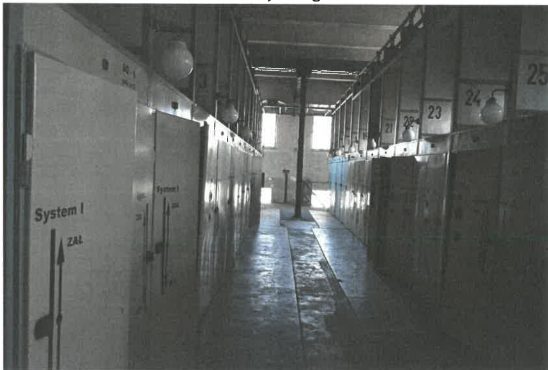
Zdjęcie 1. Rozdzielnia główna SN w Elektrociepłowni.
