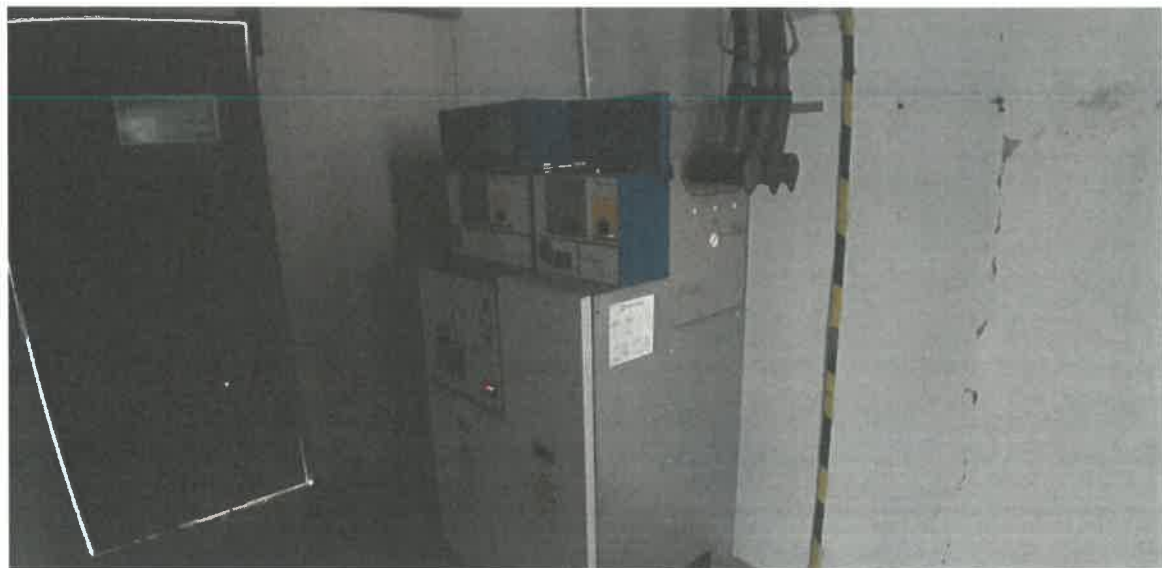
Zdjęcie 12. Rozdzielnia SN 3 polowa w SO14.
