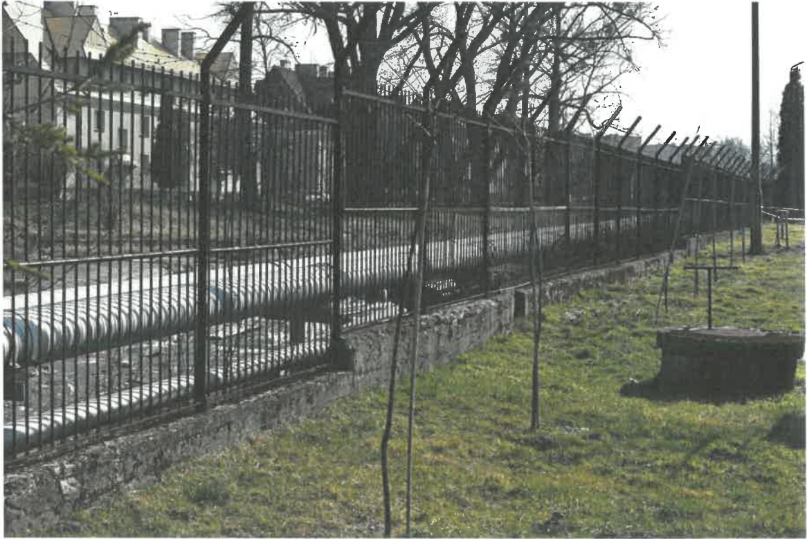
Zdjęcie 19. Sieć ciepłownicza - rurociągi przesyłowe.
