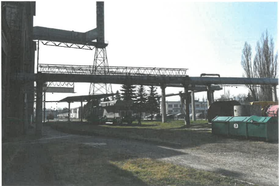
Zdjęcie 15. Rurociąg parowy, rurociąg kondensatu zasilający Andropol.
